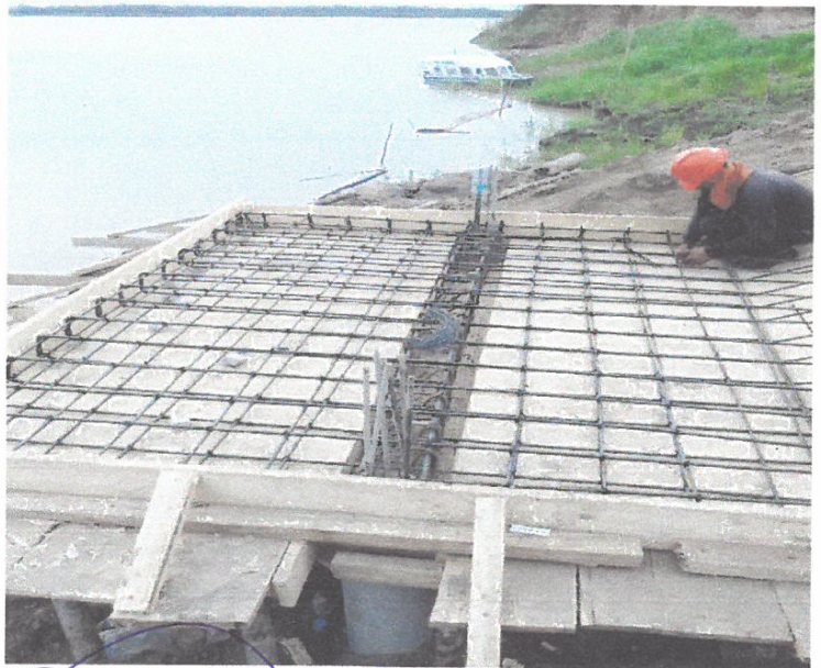
EN LA IMAGEN SE MUESTRA LA COLOCACION DE ACERO EN ESCALINATA TIPO MUELLE.
