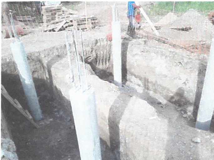
EN LA IMAGEN SE MUESTRA LAS COLUMNAS VACIADAS EN ESCALINATA TIPO MUEL
